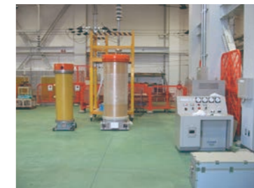
検電器試験装置
