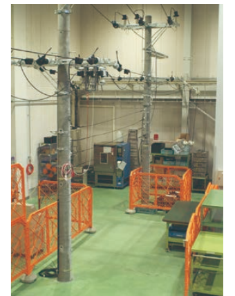
配電線模擬電柱
